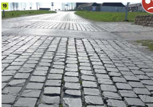
photo 19 Localement, des revêtements en pavés ou en dalles sont utilisés par souci d'esthétique ; ils posent souvent des problèmes de glissements par temps de pluie et des contraintes d'entretien élevées (rejointement de pavés).
