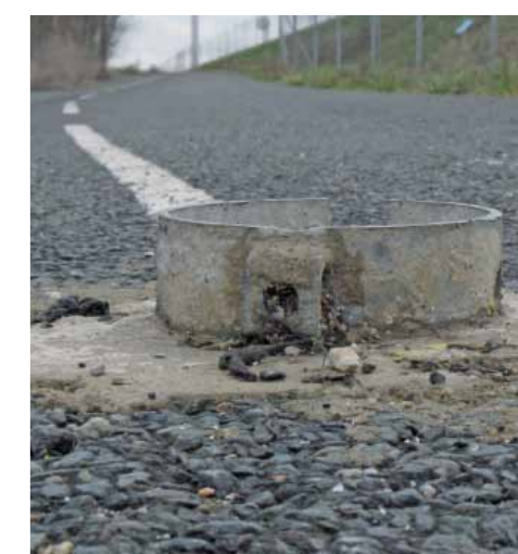
Le poteau est vandalisé et il ne reste que le socle. Le risque de chute est maximum, et les conséquences peuvent être graves
