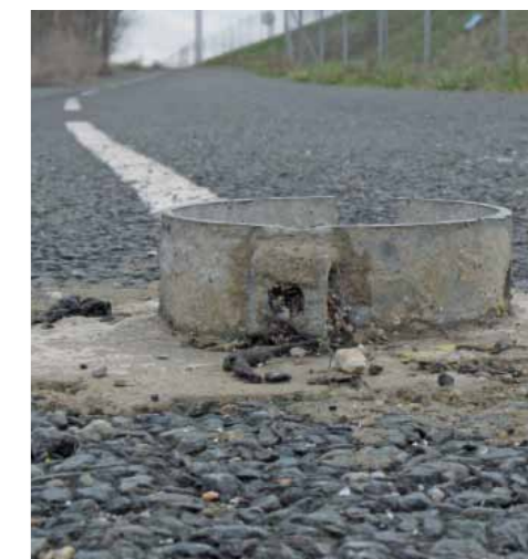
Le poteau est vandalisé et il ne reste que le socle. Le risque de chute est maximum, et les conséquences peuvent être graves
