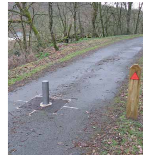
Il y avait une bande réfléchissante sur le poteau central, mais celle-ci a été arrachée : peu visible de jour par sa conception, cet obstacle est devenu dangereux de nuit
